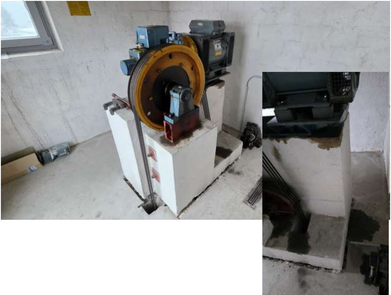
Aufzugsantriebseinheit Tölzer Str. 37 ↓
