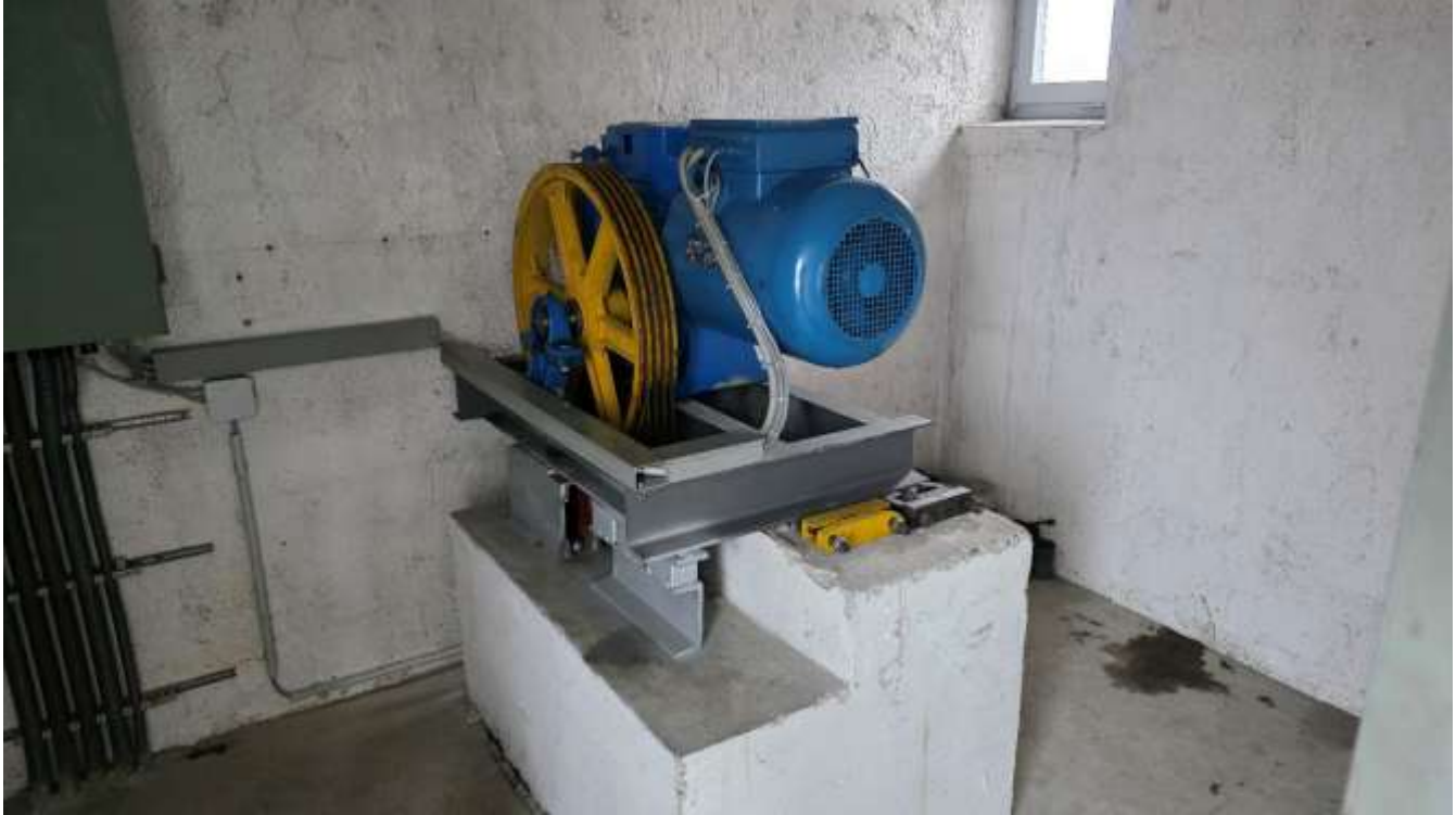
Aufzugsantriebseinheit Tölzer Str. 39 ↓
